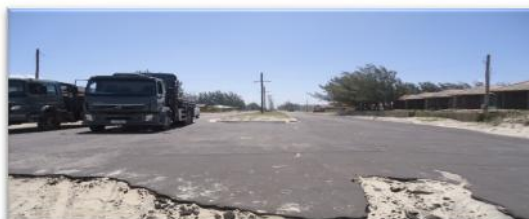
Figura 1- Estrada de acesso a costa. Péssimas condições. Mostardas/RS.
